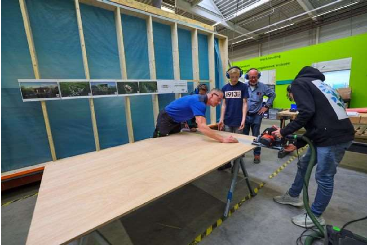
Leerlingen van het Pius X-College werken aan een tiny house. © Bert Jansen/DCI Media
